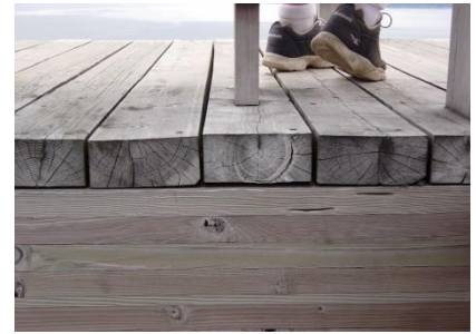
Bild 3: Trockenrisse im Hirnholz und auf den Bohlenoberflächen
