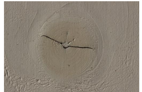
Bild 16: Ast mit Riss und Farbdurchschlag auf weißer Oberfläche
