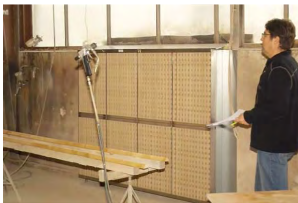
Für emissionsarmes Lackieren: Neue Modulspritzwand aus Edelstahl in der Schreinerei Hans Mast
